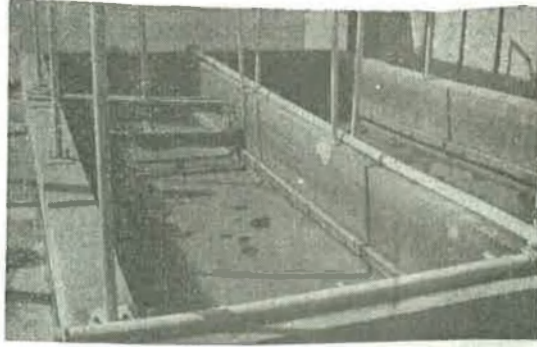
Şekil 3 — Suyu boşaltılmış bir çift temizleme havuzu varageleye asılı kasa ve ultra-viyole unitesinde temizlenen suyu getiren borular ve arka plânda kulübenin duvarı görülmektedir.
